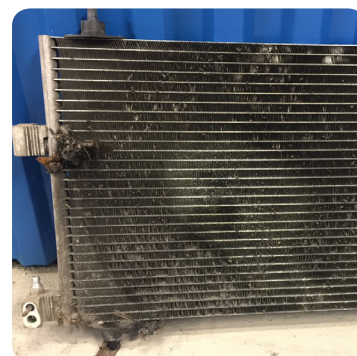
Synes at være tæt, men en kondensator i denne tilstand kan ikke fungere ordentligt og skal ubetinget udskiftes
