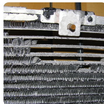
Flere rækker af manglende lameller forårsaget af kondensorkorrosion
